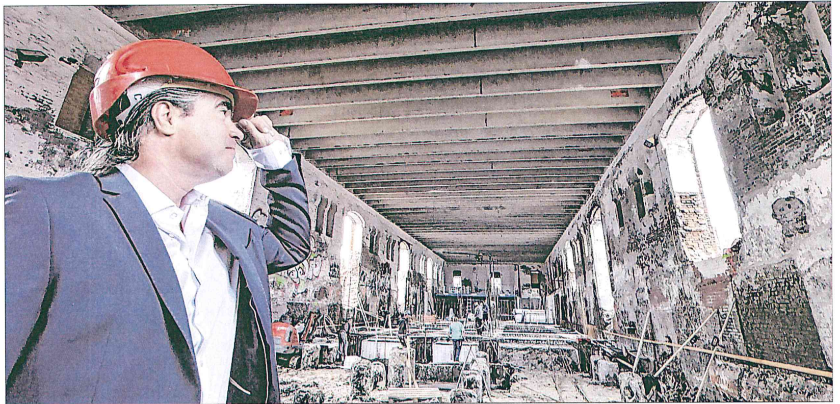
Der Architekt und Investor Paul Stein lässt das Gebäude für die Modernisierung vollständig entkernen.
