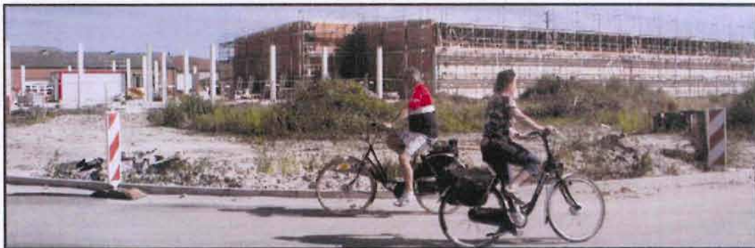
Gewerbe kommt: Das Gebäude des Edeka-Marktes ist im Rohbau zu erkennen. Links im Bild stehen die Betonpfeiler für weitere Fachmärkte. Im Hintergrund die alten Hallen, die ebenfalls genutzt werden.
